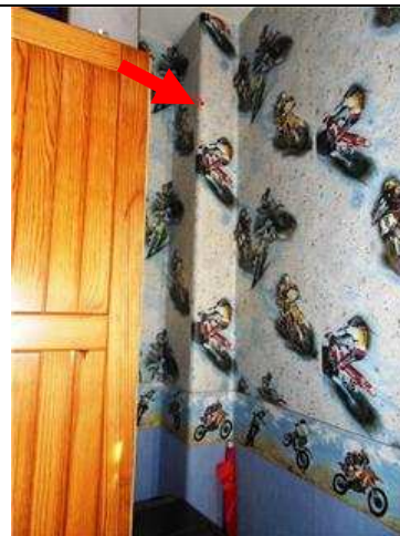
017 - Appartements - Chambre 2 LOT 0101 PH28 : amiante ciment
