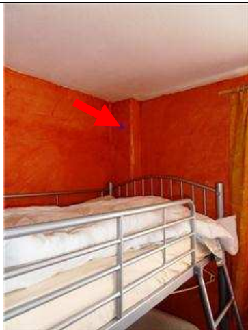
040 - Appartements - Chambre 2 LOT 0201 PH29 : amiante ciment
